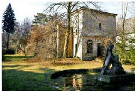
Im Schloßgarten von Klein-Wetzdorf steht das Skelett des Pflanzenhauses, seine gusseiserne Konstruktion gehörte zu den Perlen frühhistorischer Architektur in Niederösterreich; seine Rettung ist heute fast aussichtslos
