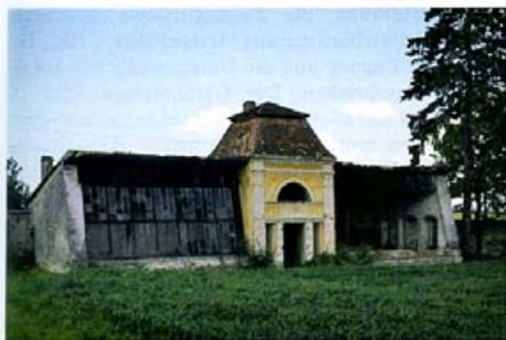
Die stark ruinierte Orangerie im Barockgarten von Harmannsdorf ist ein gefährdeter Denkmaltypus, der auf die ehemals hochstehende Gartenkultur des Landes hinweist
