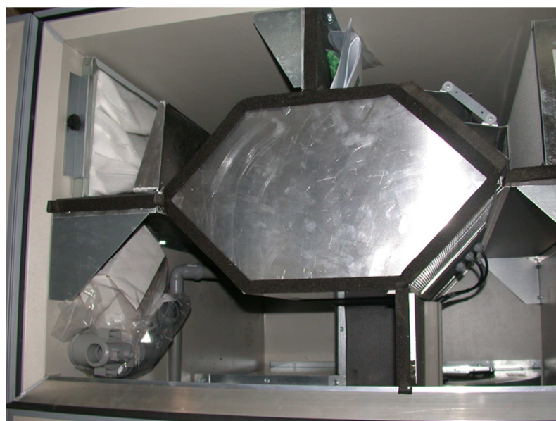
Abbildung 6: Wärmerückgewinnungseinheit des Lüftungsgerätes [AEE INTEC]
